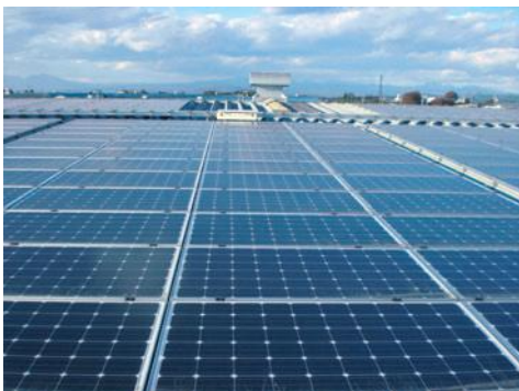
国内子会社所有建物 太陽光発電システム
